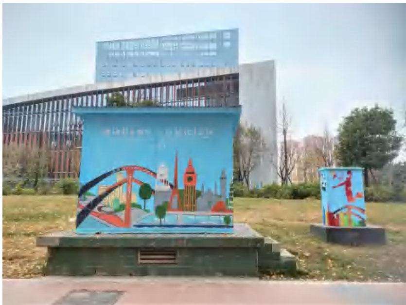
区文体中心周边路灯配电箱美化（区综合执法局供图）
